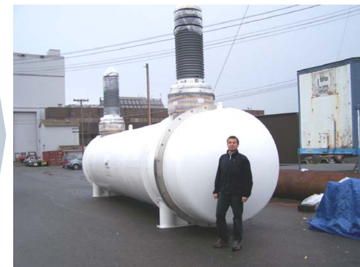
Tank für unterkühlten Stickstoff bei 72 ... 74 K und 5 bar
